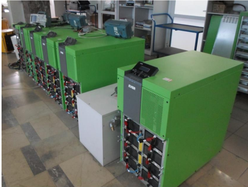
Rys. 3. Badane podczas pracy równoległej zasilacze UPS EVER POWERLINE GREEN 33 z podłączonymi miernikami
