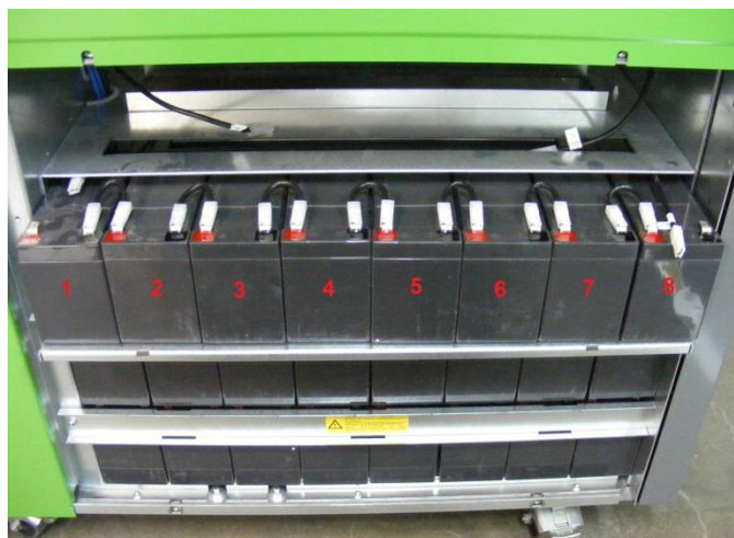
Fot. 16. Ułożenie akumulatorów pokład 3 strona lewa
