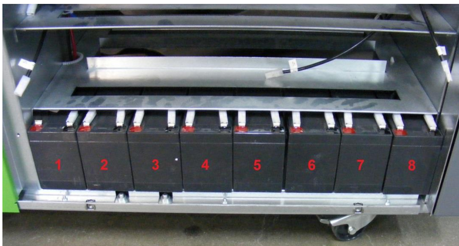
Fot. 8. Ułożenie akumulatorów pokład 1 strona lewa
