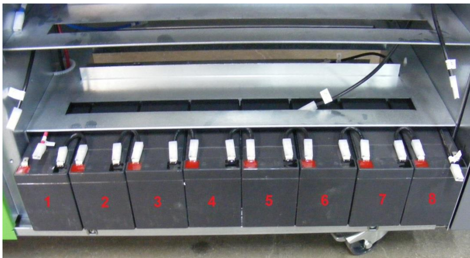
Fot. 7. Szeregowe połączenie akumulatorów
