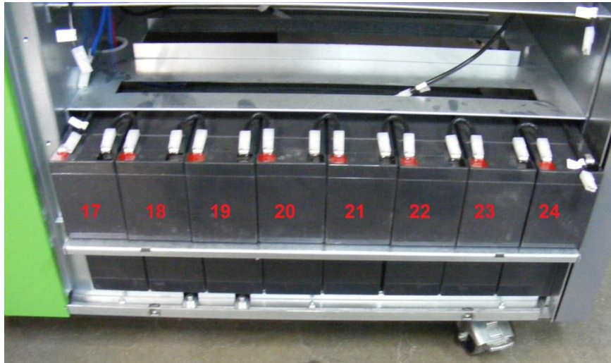
Fot. 13. Ułożenie akumulatorów pokład 2 strona lewa
