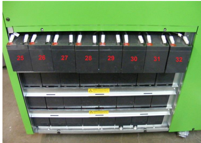
Fot. 19. Ułożenie akumulatorów pokład 4 strona prawa
