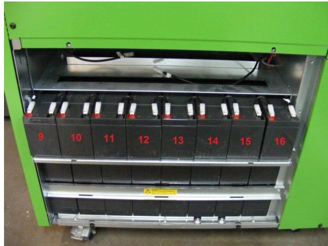
Fot. 17. Ułożenie akumulatorów pokład 3 strona prawa
