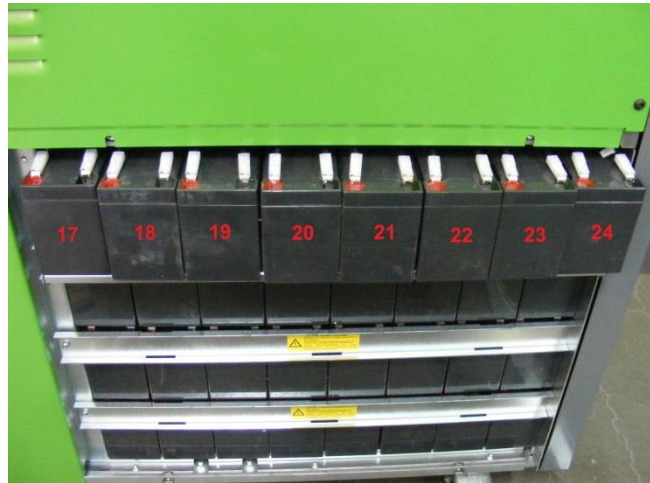
Fot. 18. Ułożenie akumulatorów pokład 4 strona lewa
