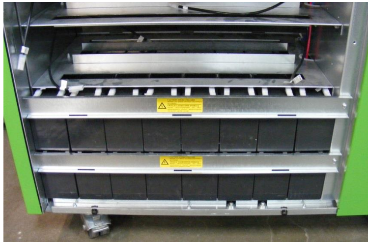
Fot. 15. Zamontowane akumulatory pokład 1 i 2
