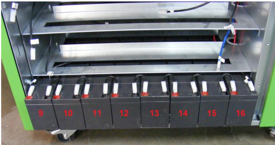
Fot. 10. Ułożenie akumulatorów pokład 1 strona prawa
