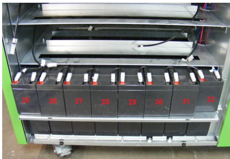
Fot. 14. Ułożenie akumulatorów pokład 2 strona prawa
