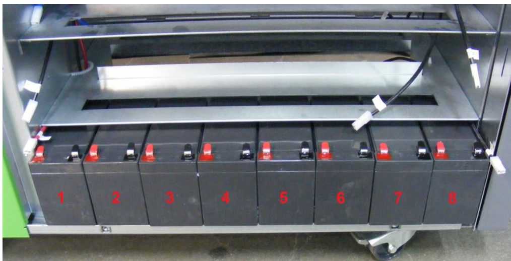
Fot. 5. Ułożenie akumulatorów pokład 1 strona lewa
