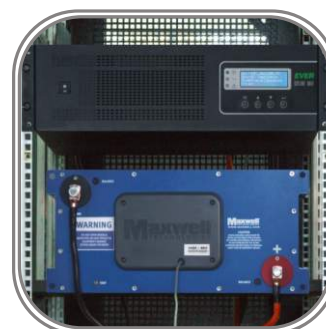
Urządzenie w szafie rackowej
